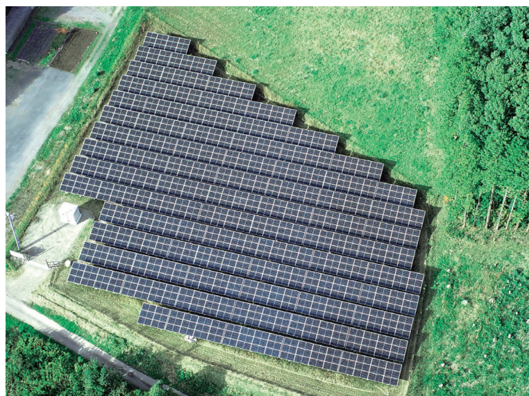
(株)三越伊勢丹の拠点に導入するPPAにおける太陽光発電施設
